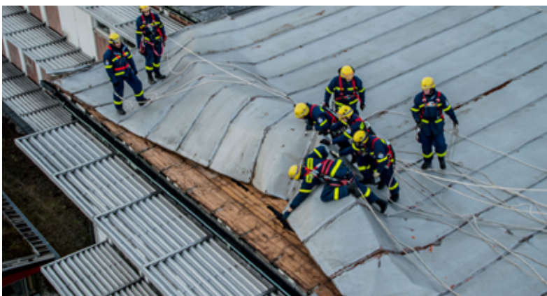
THW-Einsatzkräfte im Einsatz auf dem Dach des Josef-Hofmiller-Gymnasiums in Freising. Foto: THW/Peter Binner
