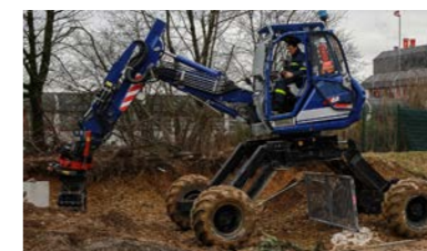
Das Überwinden eines freistehenden Hindernisses ist ohne Aufsetzen des Fahrzeuges bis zu einer Höhe von 1,10m möglich. Foto: THW/Florian Berger
