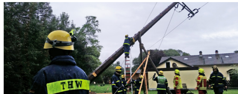
Abstützarbeiten an Strommasten, die bei den Naturereignissen stark beschädigt oder niedergeworfen worden waren. Foto: THW/Florian Huber
